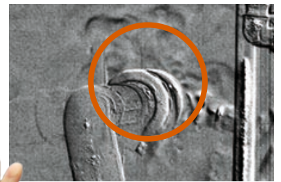
Snapshot einer Videoaufnahme mit der Gaskamera, zeigt die Biogaswolke einer Undichte in einem Kondensatschacht.
